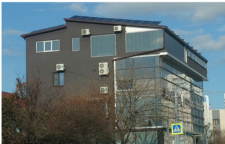
Рисунок 27 Гибридная солнечная сетевая станция на 30 кВт пик; крыша центра «Алоэ СПА» в Краснодаре
