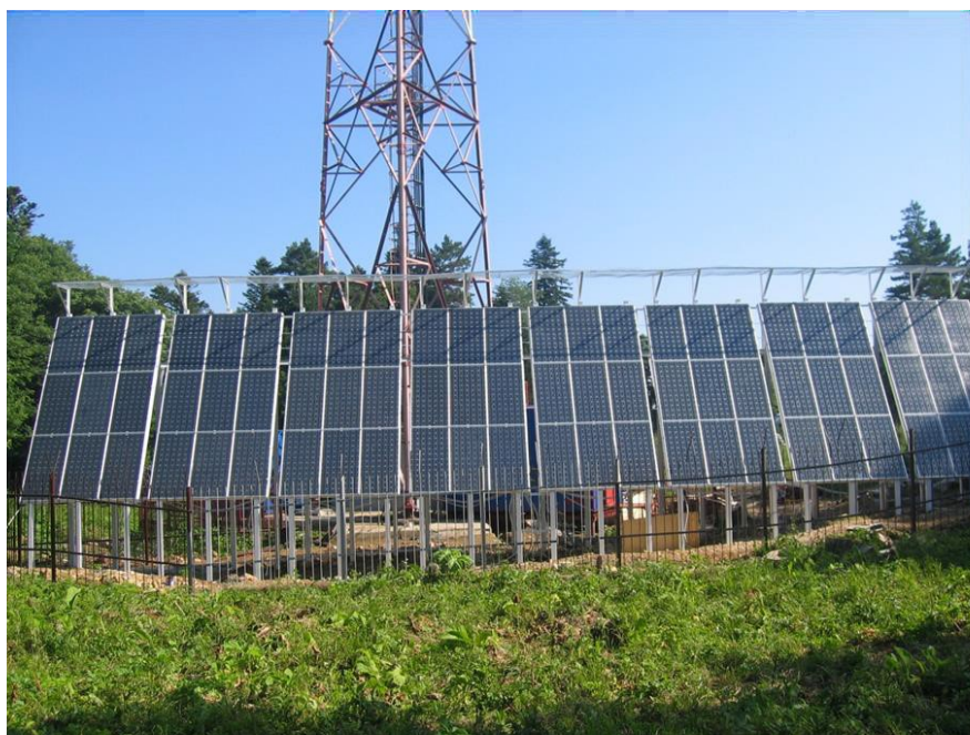
Рисунок 29 Автономная фотоэлектрическая система мощностью 10.8 кВт, станция мобильной телефонной связи «МТС» для передачи сигнала, Лаго-Наки, Краснодарский край
